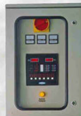
QUADRO ELETTRICO Cod. 2001
